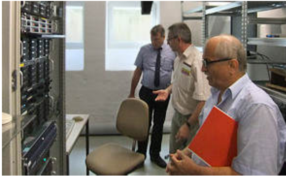
Besichtigung eines Serverraums an der Technischen Fakultät Foto/Copyright: Sebastian Starzynski, Uni Kiel
