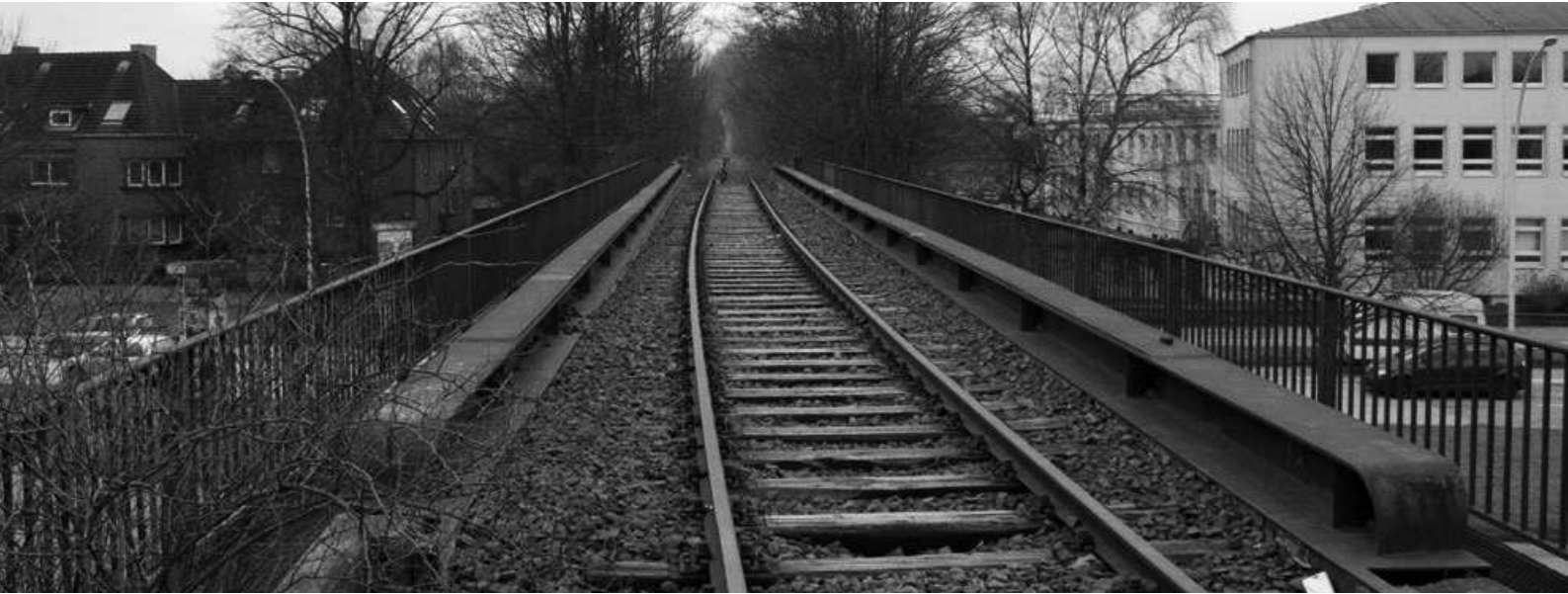
Hier soll die Veloroute entlangführen: Die alte Eisenbahnbrücke über die Eckernförder Straße
